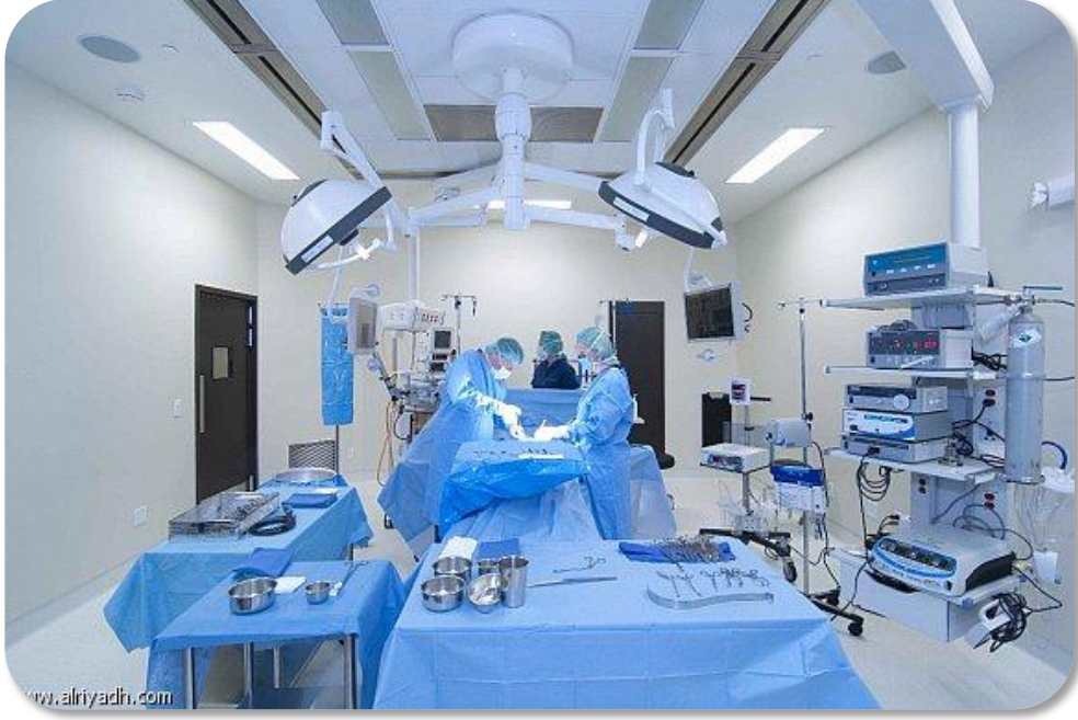
الشكل (15) الاستخدام الوظيفي للإضاءة في غرفة العمليات
