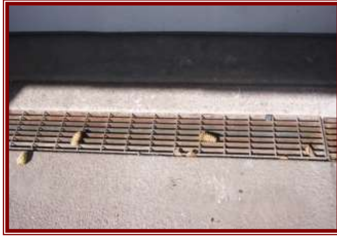
الشكل (10-20) مدخل مياه أمطار سطحي
