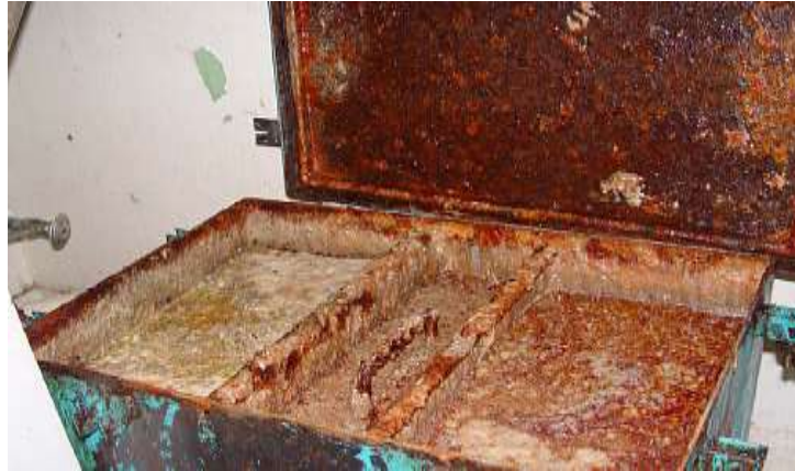
الشكل (10-26) مصيدة زيوت رديئة ومملوءة بالزيوت
