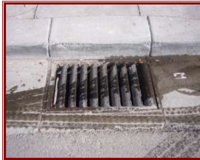
الشكل (19-10) مدخل مياه أمطار سطحي
