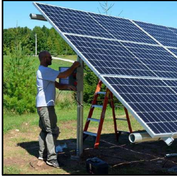
شكل (5-45) اطار تثبيت الألواح الشمسية
