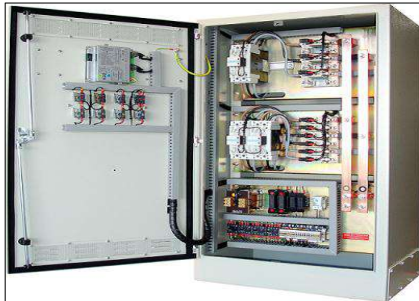
شكل (4-6) لوحة التوزيع الكهربائي الخارجي
