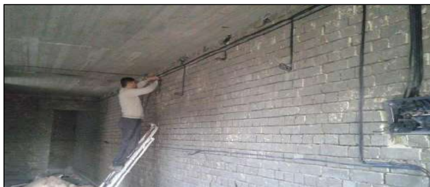
شكل (3-8) التأسيس الكهربائي تحت البياض
