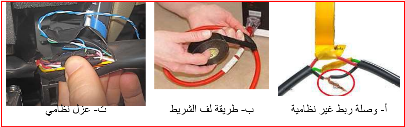
شكل 5-10 استعمال شريط العزل لعزل الوصلات الكهربائية
