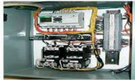
لوحة تحكم تعمل بنظام PLC
