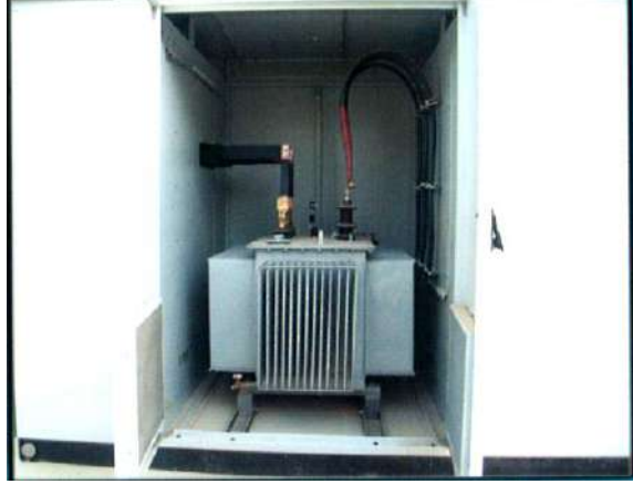
الشكل (4-7) a نصب محول توزيع خافض للجهد داخل المحطة الصندوقية (KIOSK)
