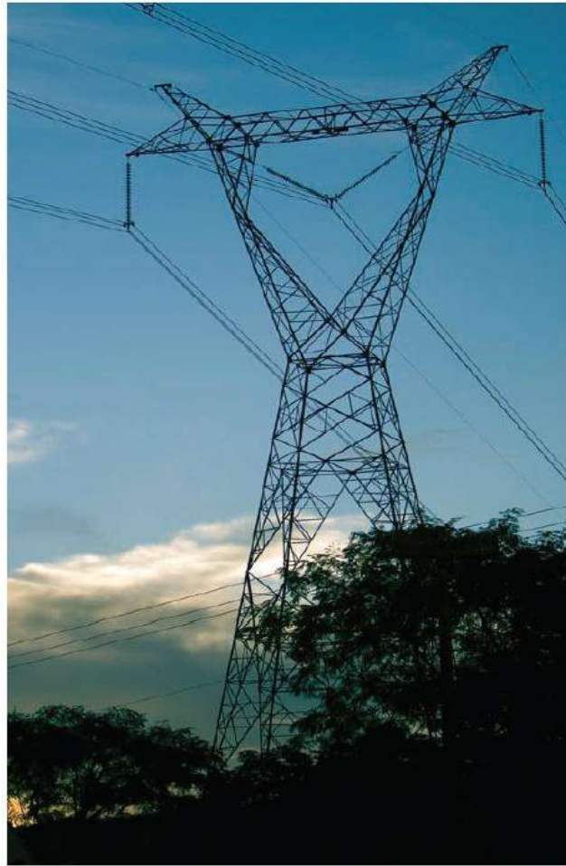
الشكل (2-4) برج ضغط عال 400KV
