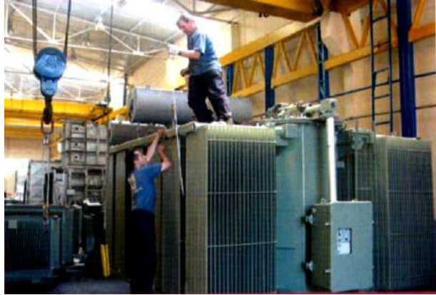
الشكل (4-3) مركز صيانة لأحد محولات القدرة سعة 3150KVA
