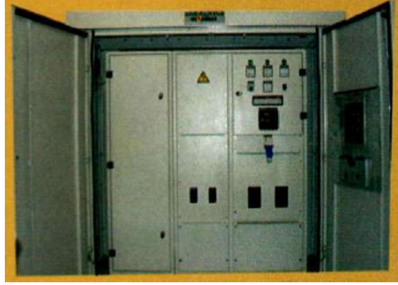
الشكل (4-53) لوحة توزيع جهد منخفض ضمن محطة التوزيع الصندوقية KIOSK
