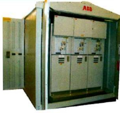
الشكل (4-51) لوحة توزيع جهد متوسط ضمن المحطة الصندوقية KIOSK
