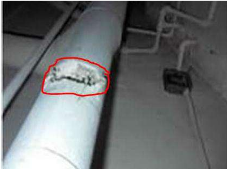
الشكل (1-25) يوضح تحديد المنطقة المتضررة
