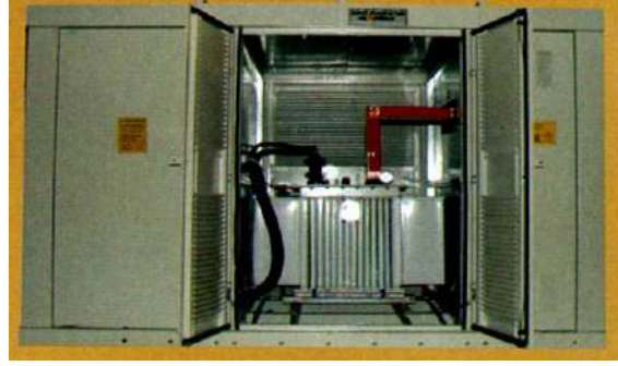
الشكل (4-10) المحطة الصندوقية سعة 1000KVA
