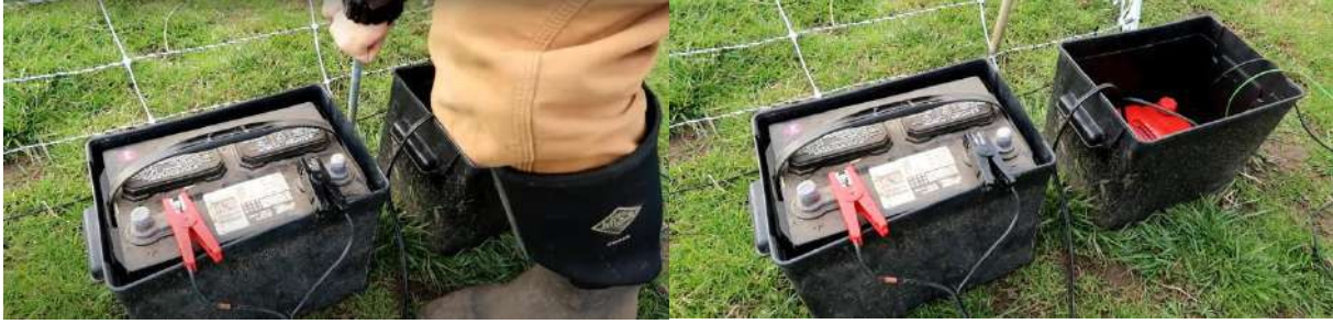
شكل (30-6) ربط قطبي بطارية الرصاص بالمنشط. شكل (31-6) تهيئة القطب الأرضي بغرس قضيب معدني بالأرض.
