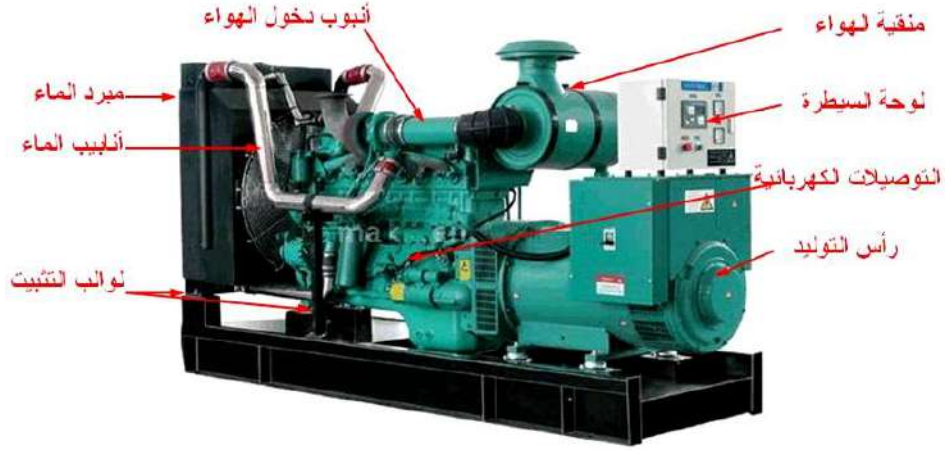
شكل (3-1) يوضح مولد كهرباء بمحرك ديزل
