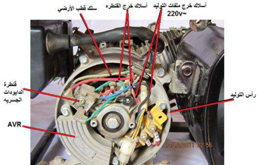
شكل (8-31) يوضح خرطوم أسلاك التوصيل بين وحدة مأخذ المولد ورأس التوليد
