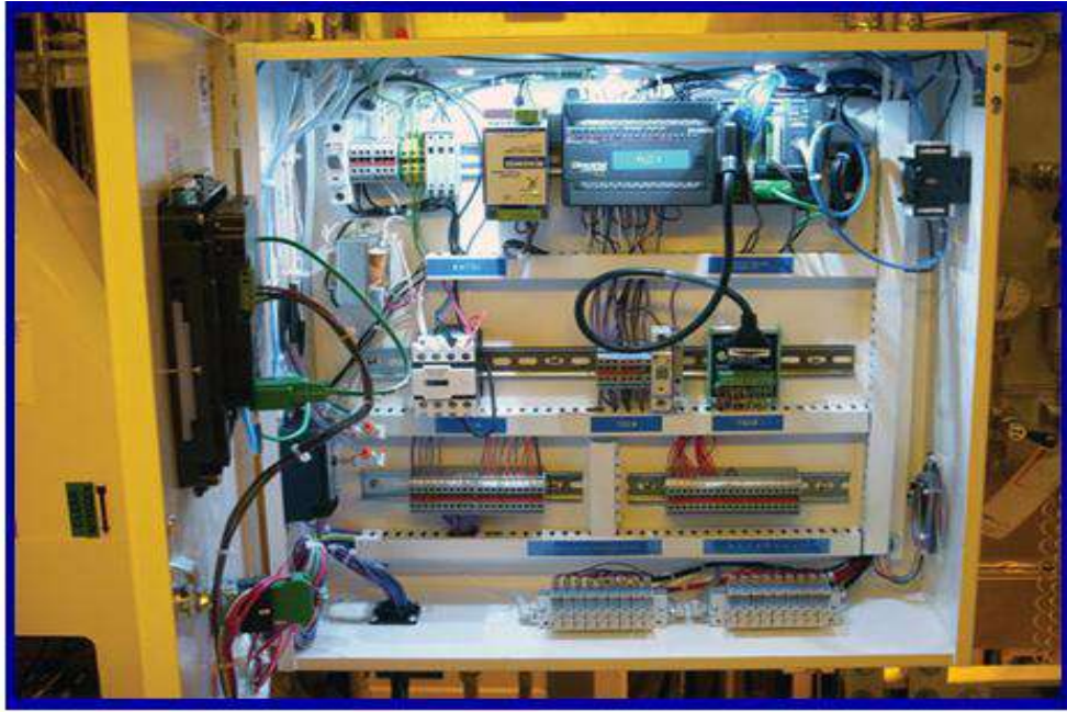
شكل (1-6) جهاز (PLC) مع عناصر دخل وخرج في لوحة سيطرة متكاملة لمصعد كهربائي
