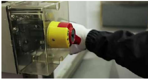
شكل (1 - 21) إطفاء مصدر الطاقة الكهربائية للمصعد
