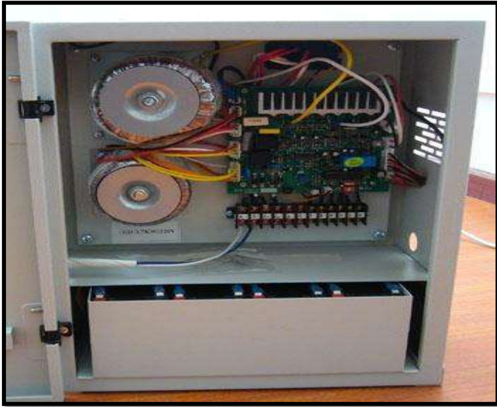
شكل (37-3) وحدة تجهيز القدرة الاضطرابي (ups)
