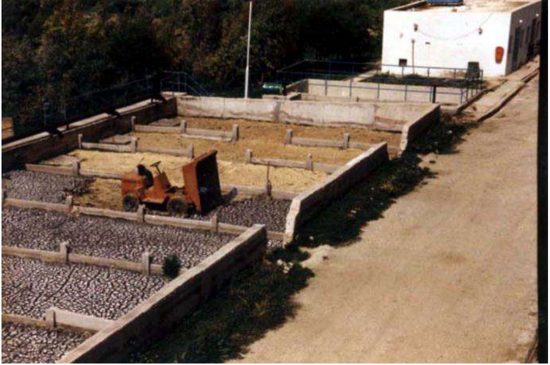
الشكل (3-6) تبين أحواض تجفيف الحمأة
