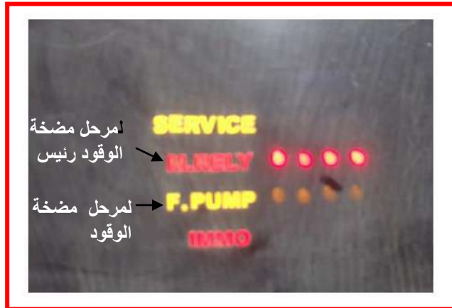
شكل (1-41) إشارة مرحل مضخة الوقود
