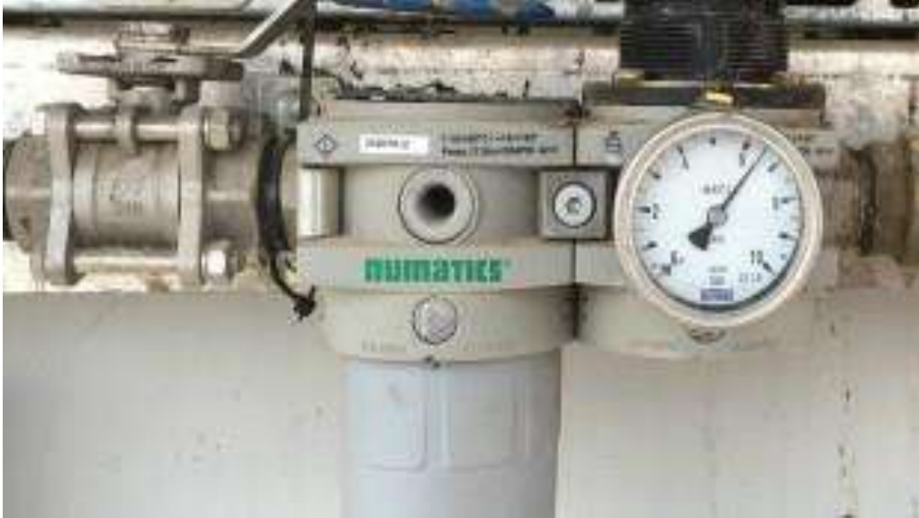
شكل (1- 16) منظم ضغط الهواء مربوط على خط تصريف الهواء في ضاغط الهواء
