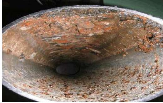
شكل (1 - 64) تآكل الانابيب
