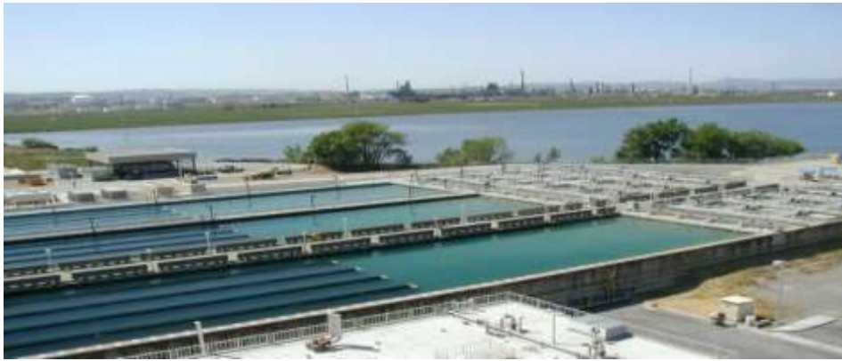
شكل ( 4 - 9 ) احواض التركيز في محطة معالجة المياه
