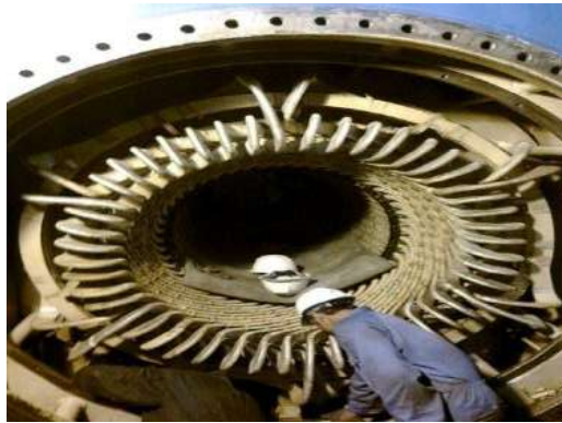
الشكل (1-13) يوضح الجزء الثابت لمولد في محطة كهرباء جنوب بغداد الحرارية
