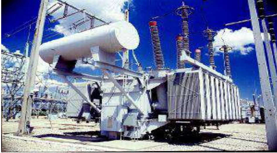
الشكل (2-6) يوضح محطة خفض
