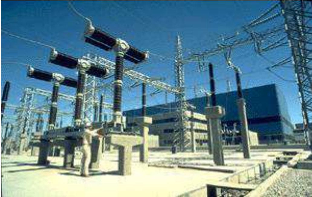
الشكل (1-6) يوضح محطة رفع
