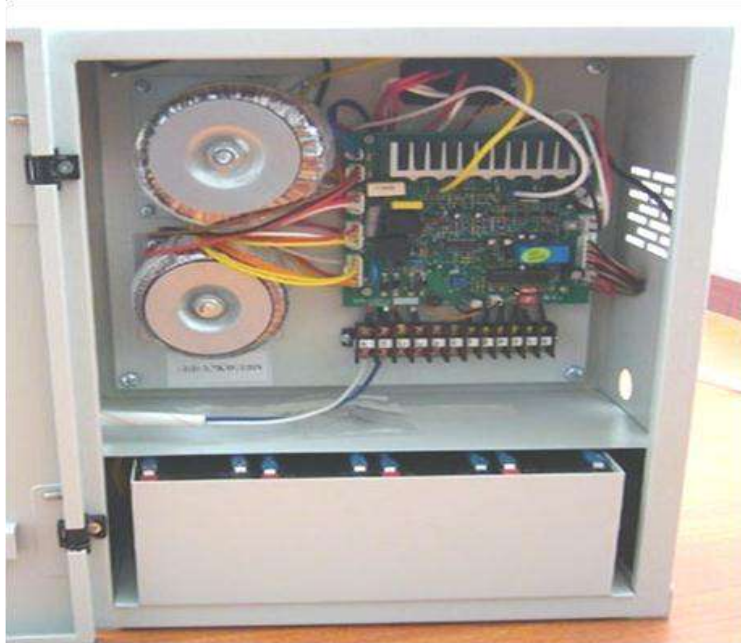
شكل 3 - 42 لوحة مجهز القدرة الأضطراري للمصعد الكهربائي
