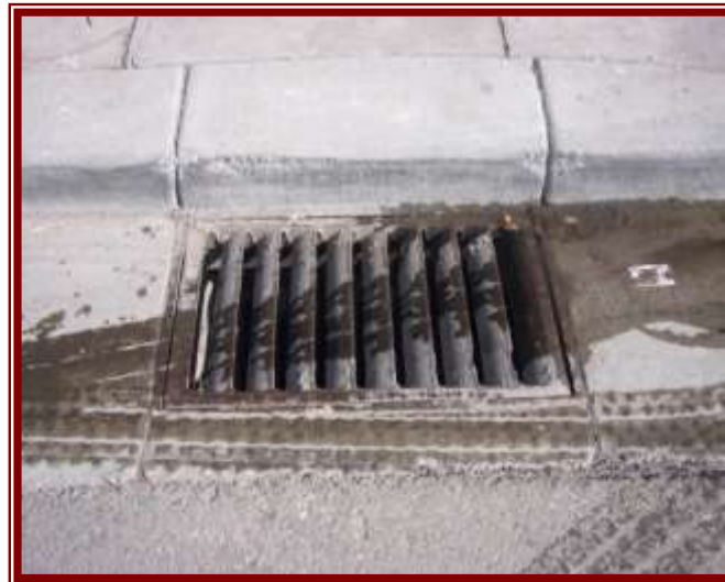
الشكل (19-10) مدخل مياه أمطار سطحي
