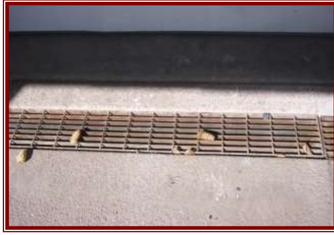
الشكل (10-20) مدخل مياه أمطار سطحي
