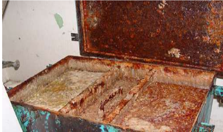
الشكل (10-26) مصيدة زيوت رديئة ومملوءة بالزيوت
