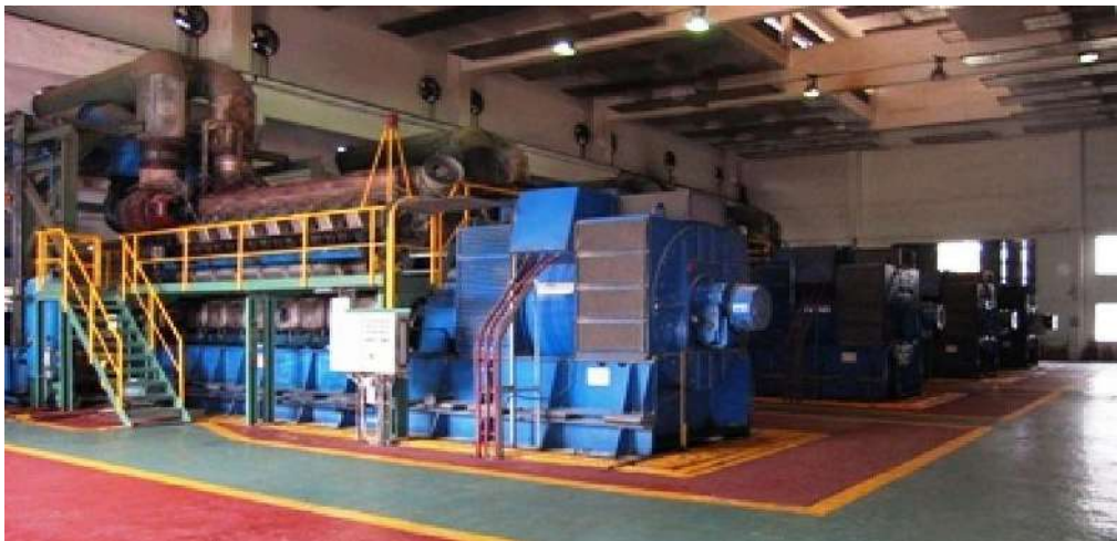
شكل ( 5 - 9 ) يوضح محطة توليد الطاقة الكهربائية تعمل بمحركات الديزل
