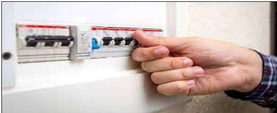
الشكل (7-1) فصل التيار الكهربائي
