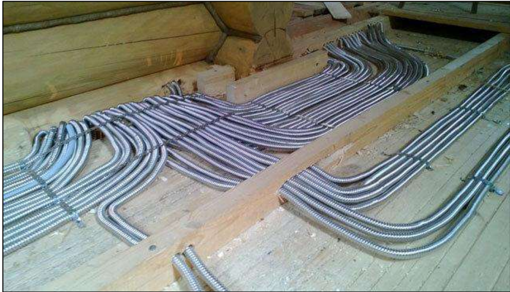
شكل (10-3) التأسيس الكهربائي باستخدام الانابيب
