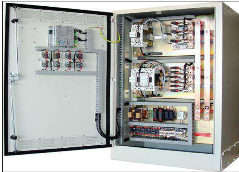
شكل (4-6) لوحة التوزيع الكهربائي الخارجي
