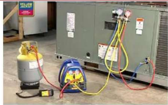
9- الشكل النهائي لربط مجموعة استرجاع مائع التثليج بوحدة تكيف هواء مجمدة
