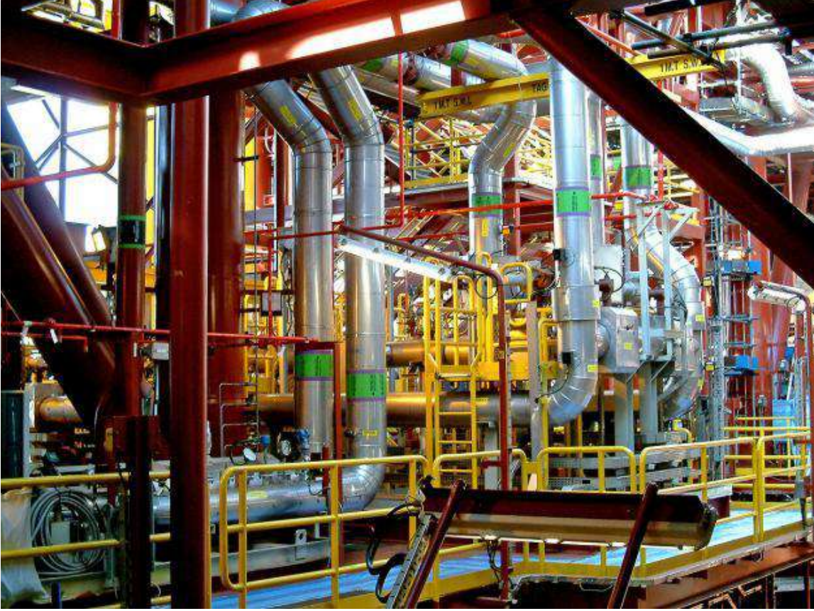
الشكل (١٠-١) يوضح شبكة أنابيب في محطة حرارية لتوليد الطاقة الكهربائية
