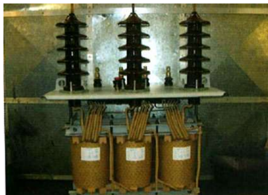
الشكل (٤-٤) يبين التركيب الداخلي لأحد محولات القدرة
