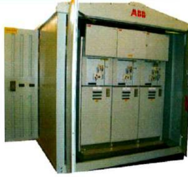
الشكل (٤-٥١) لوحة توزيع جهد متوسط ضمن المحطة الصندوقية KIOSK
