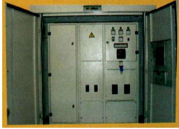
الشكل (٤-٥٣) لوحة توزيع جهد منخفض ضمن محطة التوزيع الصندوقية KIOSK
