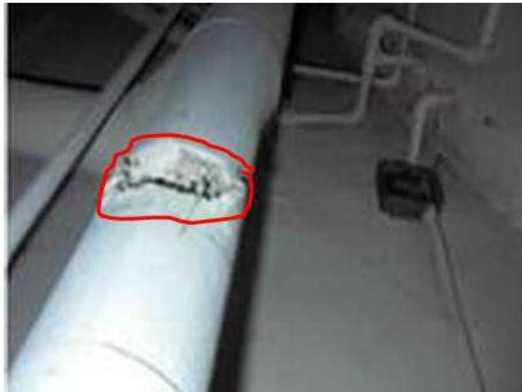
الشكل (٢٥-١) يوضح تحديد المنطقة المتضررة
