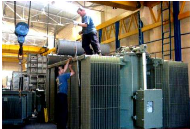
الشكل (٤-٣) مركز صيانة لأحد محولات القدرة سعة 3150\text{KVA}
