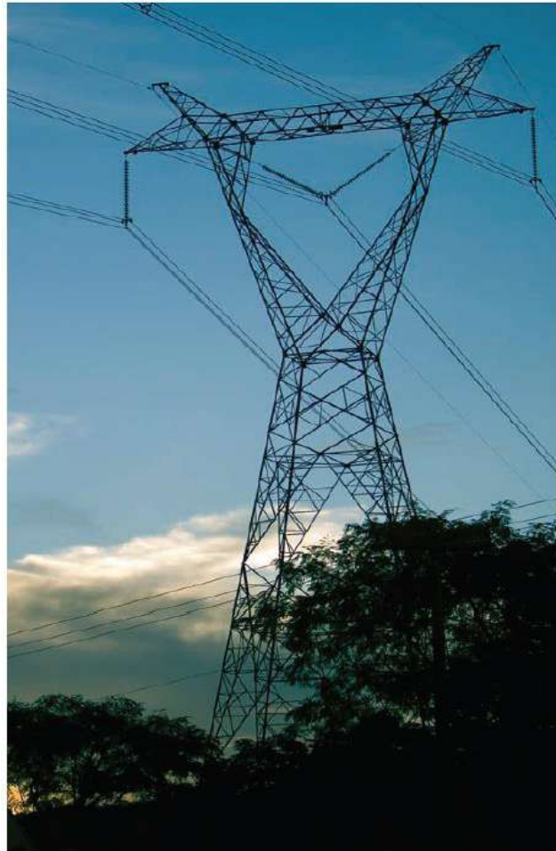
الشكل (٢-٤) برج ضغط عال 400KV
