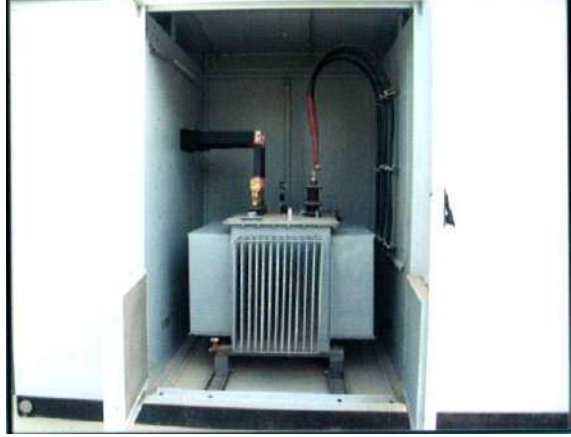
الشكل (٤-٧) a نصب محول توزيع خافض للجهد داخل المحطة الصندوقية (KIOSK)
