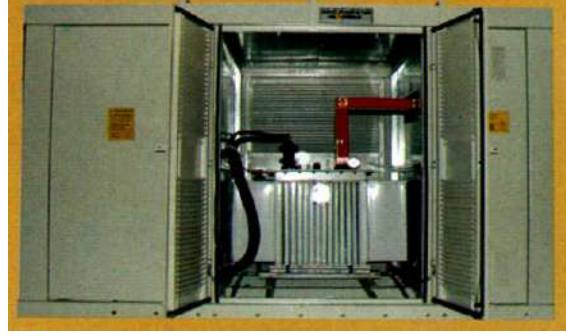
الشكل (١٠-٤) المحطة الصندوقية سعة ١٠٠٠ KVA
