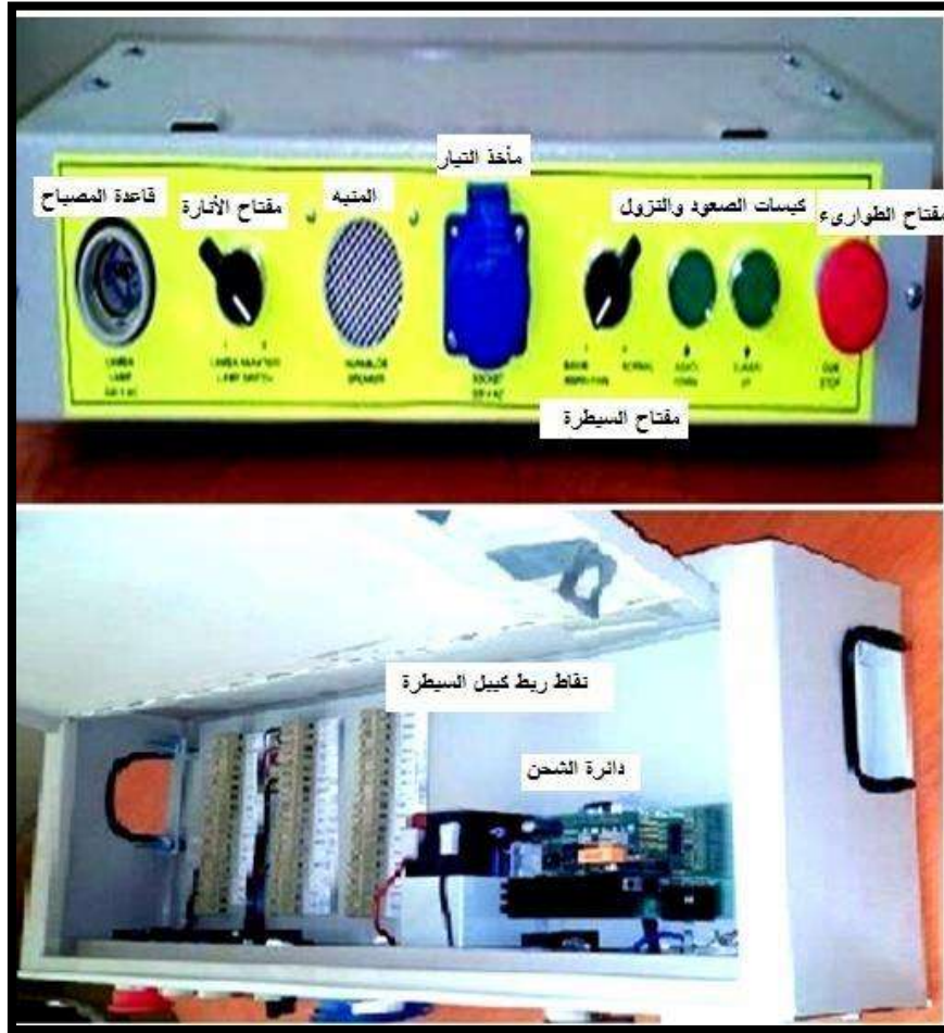
شكل (34-3) صندوق صيانة المصعد الكهربائي
