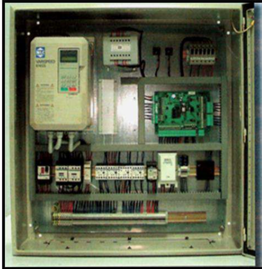
الشكل (2-3) محتويات لوحة سيطرة لمصعد كهربائي
