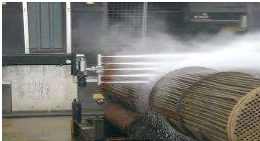
شكل (1 - 62) تنظيف خارجي لمبادل حراري
