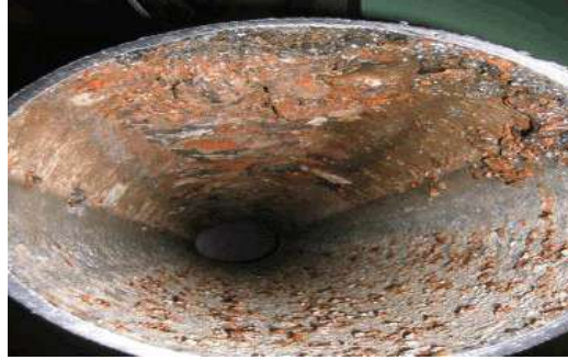
شكل (1 - 64) تآكل الانابيب
