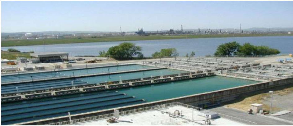
شكل ( 4 - 9 ) احواض الترسيد في محطة معالجة المياه
