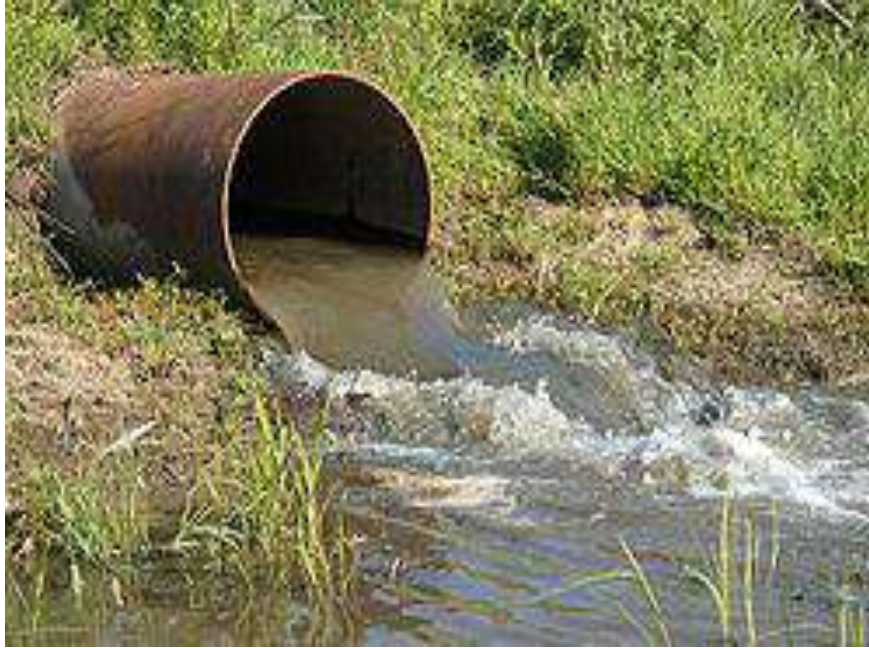
شكل ( 6 - 3 ) مياه ملوثة بمخلفات الصرف الصحي
