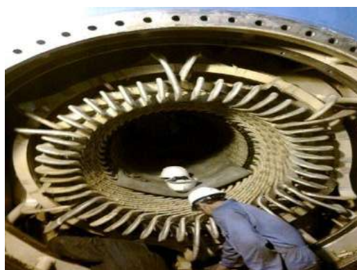
الشكل (13-1) يوضح الجزء الثابت لمولد في محطة كهرباء جنوب بغداد الحرارية
