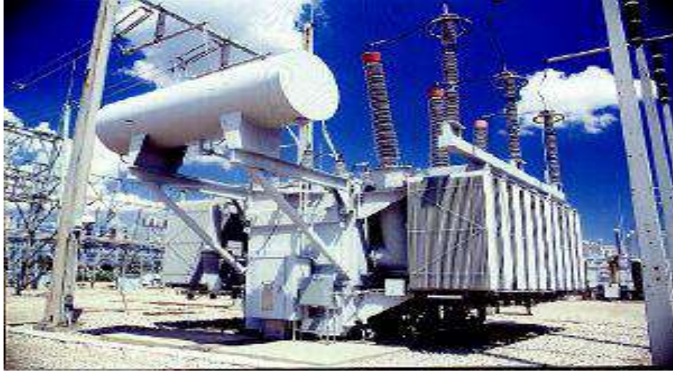
الشكل (2-6) يوضح محطة خفض
