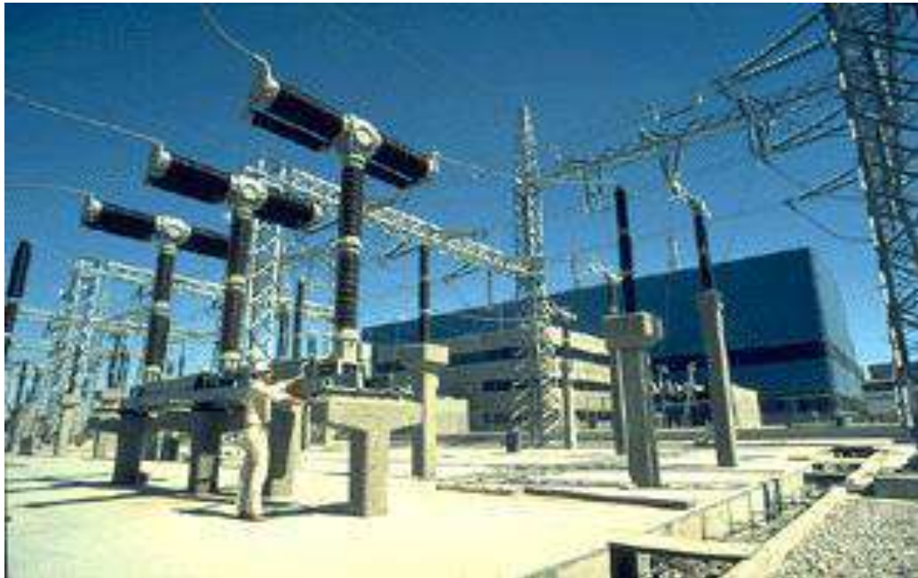
الشكل (1-6) يوضح محطة رفع
