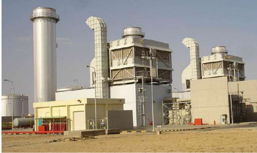
الشكل (1-2) يوضح محطة توليد كهرباء غازية
