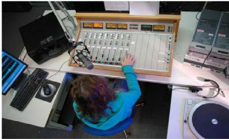
الشكل 5 - 1 أجهزة نقل الصوت في غرفة السيطرة
