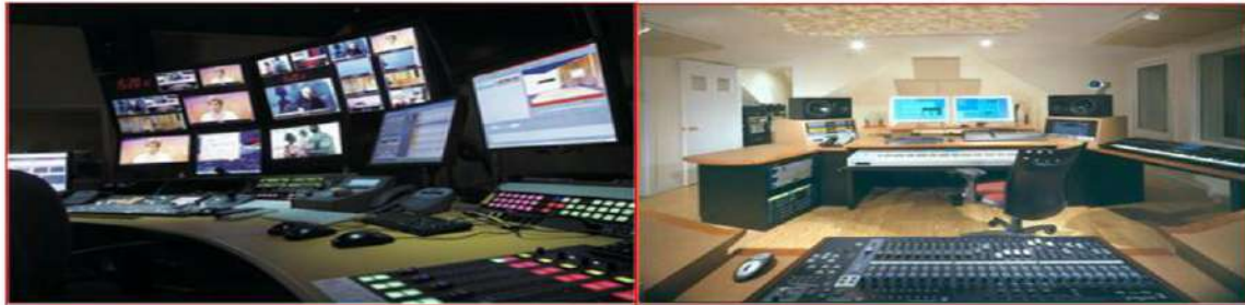
الشكل 3 - 15 غرفة التحكم
