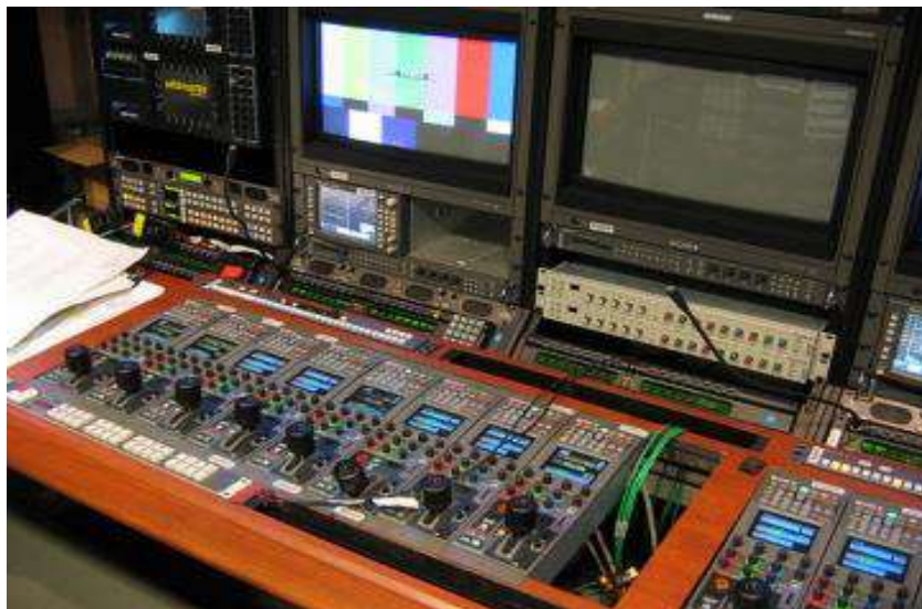
الشكل (5-5) أجهزة غرفة المراقبة التلفزيونية
