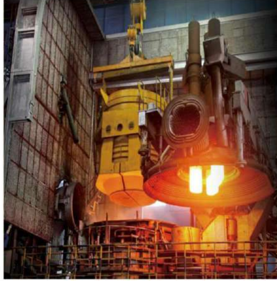
شكل ( 22-1 ) صورة فرن قوس كهربائي أثناء رفع السقف
