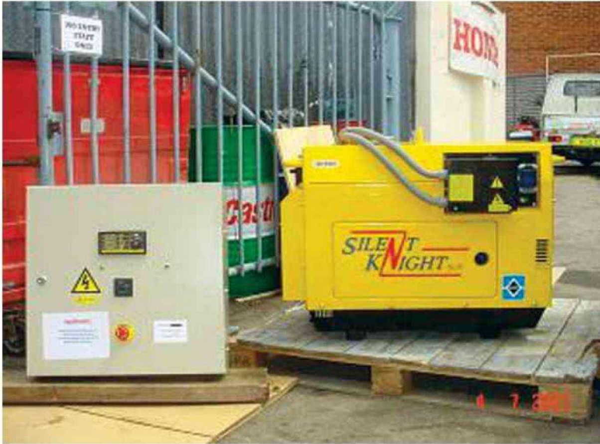
صورة تمثل مفتاح التحويل الآلي مثبت الى جانب مولدة لتزويد البناية المعينة بالطاقة الكهربائية بدون انقطاع
