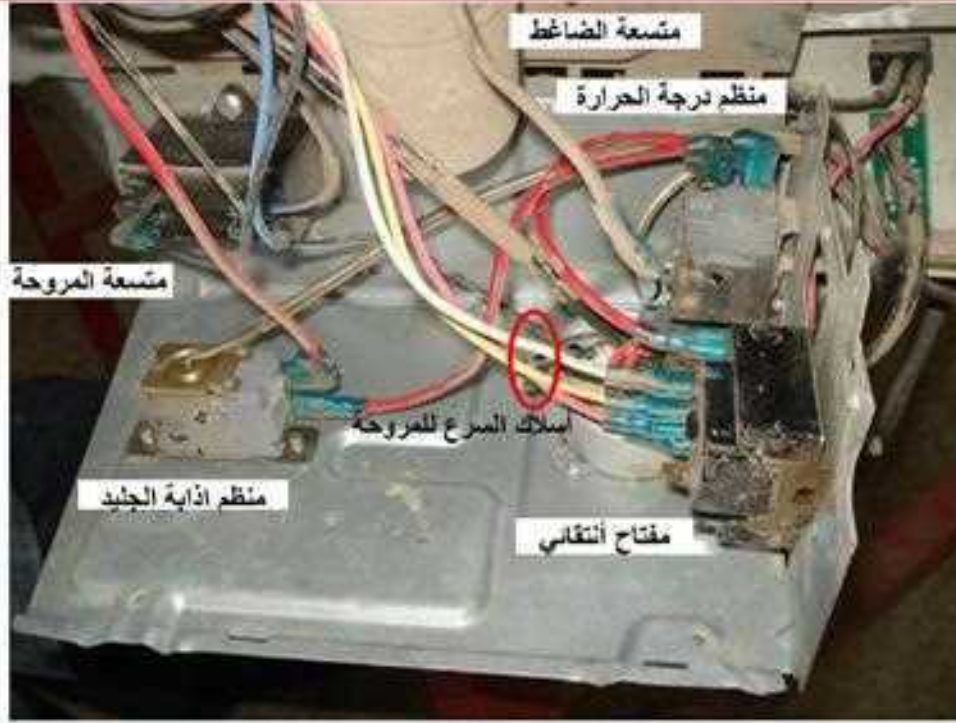
7- تفاصيل الصندوق الكهربائي لأسلاك المكيف
