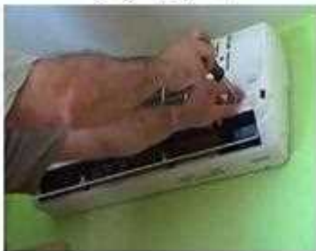
6- استعمل المفك لفتح لولب اللوحة الكهربائية
