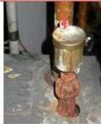
1- طاردة هواء أعلى المرجل
