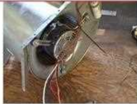
1- نافخ الهواء الخاصة بالمرجل
