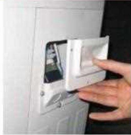
4- فتح غطاء لوحة الربط الكهربائي للوحدة الخارجية
